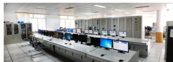
机房内设备实物示意
